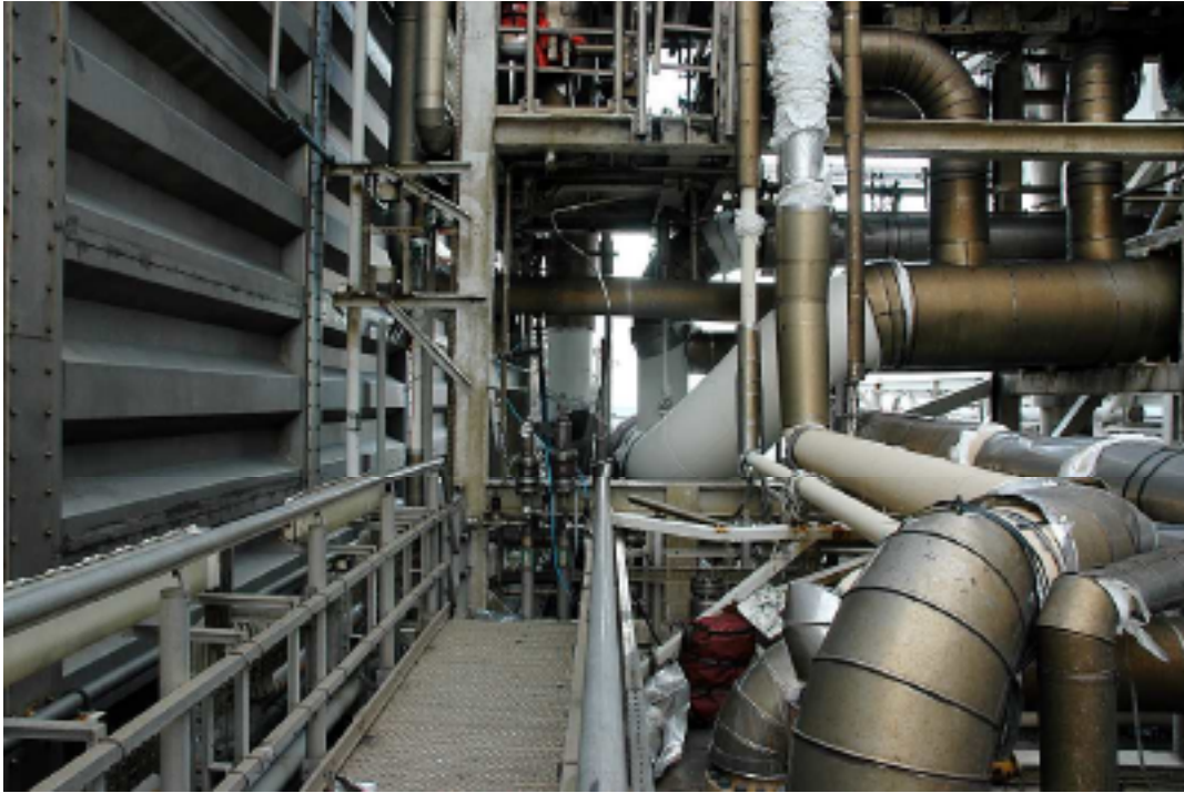
Figur 8 Skader på brannisolasjon
