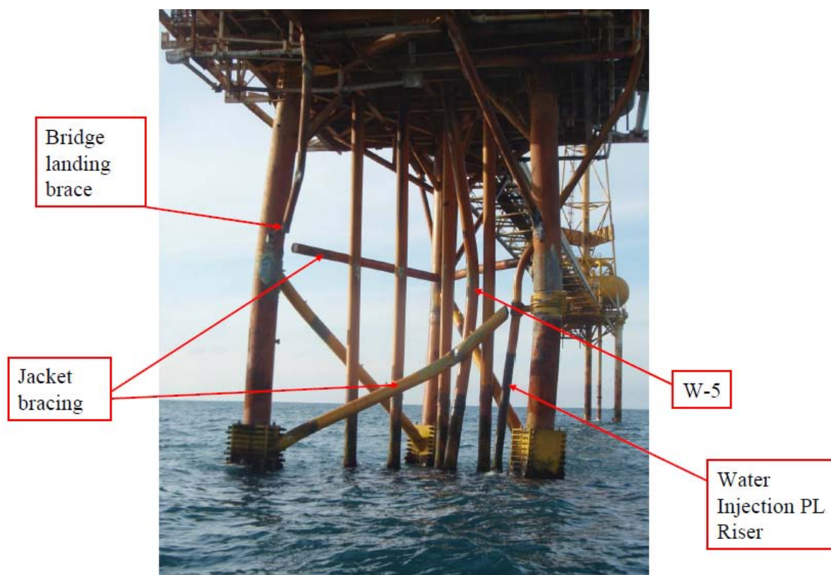
Bilde 3: Skader på Ekofisk 2/4-Ws bærende konstruksjon, konduktor og stigerør (kilde: ConocoPhillips)
